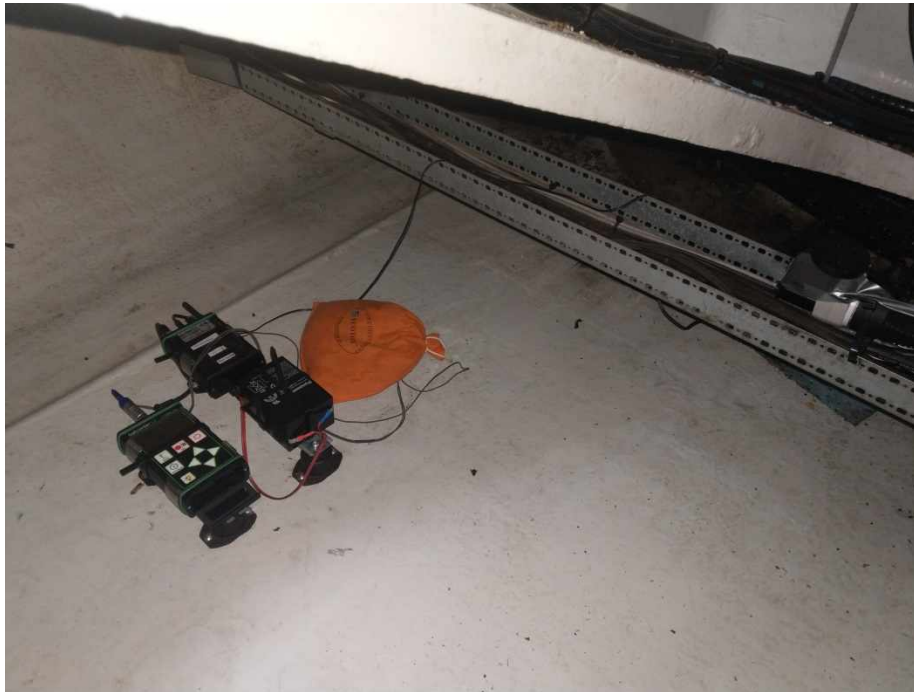
Foto 1: im Gondelboden eingebautes Aufnahmesystem
